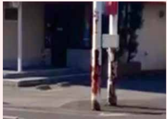
ポールの根腐れ（実際に倒れた看板）
