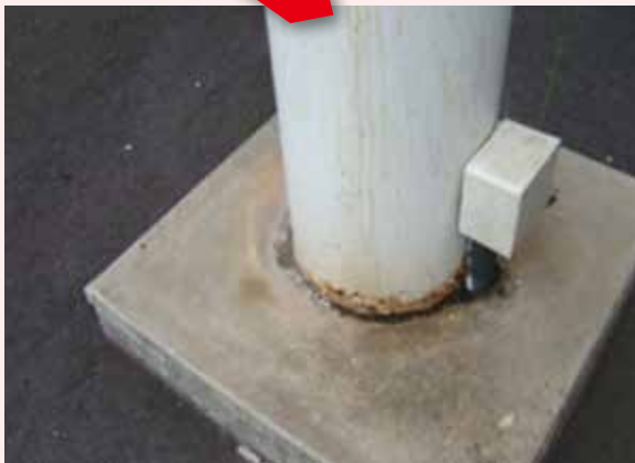
ポールの根元にサビが発生
