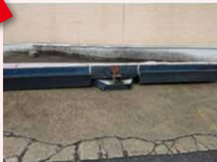
落下した欄間看板
