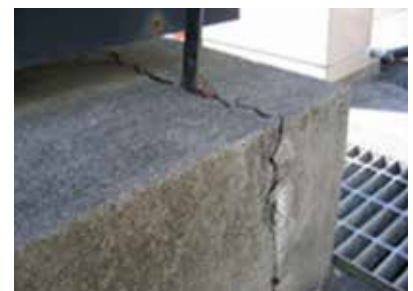
看板基礎のひび割れ
